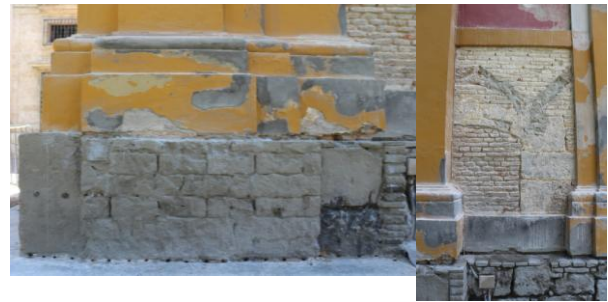
Figura 2. Catas practicadas en la fachada Este de la Cárcel de la RFTS: a) Pedestal de sillería de la esquina; b) Lienzo del paramento picado 2013.
