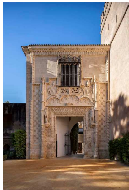
Figura. 3. Puerta de Marchena del Real Alcázar de Sevilla. En la intervención de restauración, una vez realizado el proceso de limpieza y consolidación estructural se aplicaron morteros de cal en las juntas, morteros pétreos y piedra en las recomposiciones, y finalmente la fábrica y esculturas se protegieron y consolidaron
