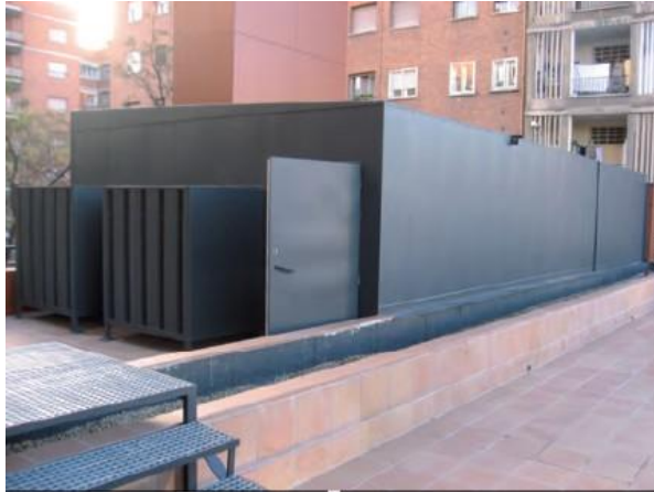
Ilustración 3: Ejemplo de cerramiento acústico
