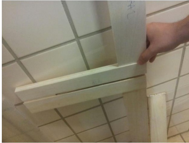
Figura 6.14. Fisura encontrada al retomar la construcción del prototipo
