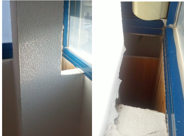
Fig. 36: Fotografías de localización de la Inspección nº 11. En estas fotografías se observa el orificio que presenta el recubrimiento del pilar, a través del cual se han medido elementos del interior y se han tomado fotografías que documenten los resultados. (Elaboración propia).
