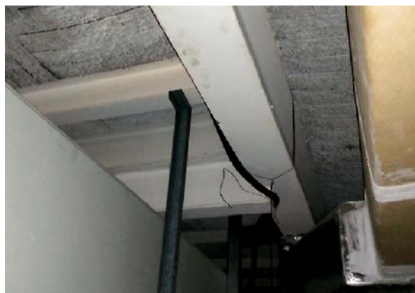
Fig. 29: Fotografía obtenida en Inspección nº 6. En esta fotografía se observa el brochal que resuelve el hueco de la escalera, consistente en el montaje de dos perfiles IPE superpuestos. (Elaboración propia).
