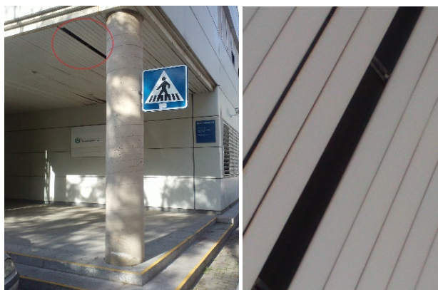
Fig. 30: Fotografías de localización de la Inspección nº 8. En ellas puede observarse la lama que falta en el falso techo, y que se ha aprovechado para analizar el mismo. (Elaboración propia).
