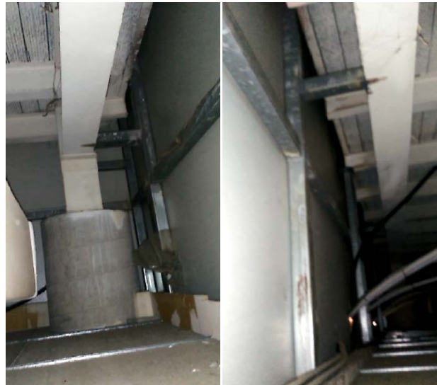
Fig. 28: Fotografías obtenidas en la inspección nº 5. En las mismas se observa la composición del cerramiento de fachada, así como sus anclajes a la estructura del edificio y los perfiles IPE 120 que resuelven el vuelo del forjado. (Elaboración propia).
