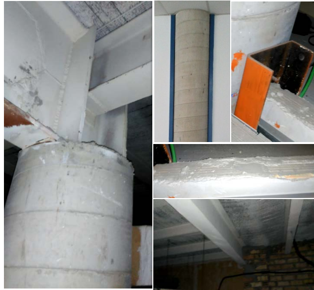
Fig. 24: Montaje de fotografías obtenidas tras la inspección nº 2. En las presentes se observan los elementos que se han analizado en esta cata, mencionados a la izquierda. (Fotografías de elaboración propia).
