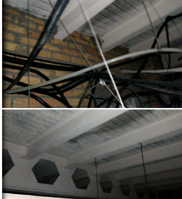
Fig. 23: Ejemplos de fotografías obtenidas en la Inspección nº 1. En la imagen superior se observa la partición central de Planta Baja, que como se observa consiste en una citara de ladrillo hueco doble, que se alarga por toda la altura libre entre forjados. En la imagen inferior se ve la disposición de las viguetas que sustentan el forjado de Planta Primera, así como sus uniones a la viga alveolar existente. (Ambas fotografías de elaboración propia).
