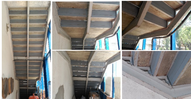
Fig. 81: Composición fotográfica de la estructura metálica que conforma la escalera del edificio. (Elaboración propia).
