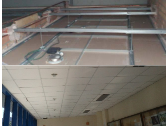
Fig. 88: Fotografías de falso techo. En ellas puede observarse el falso techo desde la parte inferior y superior del mismo, quedando perfectamente definido. (Elaboración propia).
