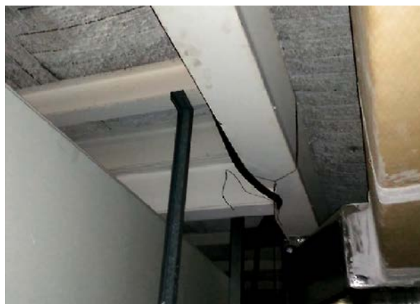
Fig. 63: Fotografía de Brochal nº 3 obtenida en la inspección nº 6. (Elaboración propia).
