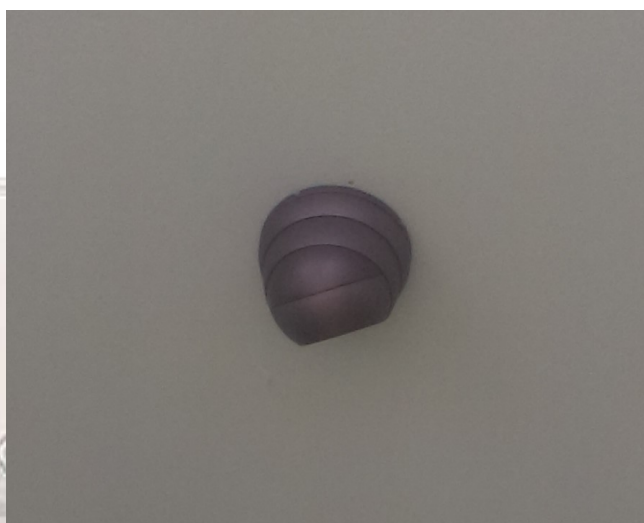
Imagen 54 : Sensor detector de humos colocado en techo del pasillo Fuente: Fotografía de la autora
