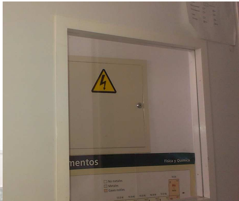
Imagen 58: Cuadro eléctrico alojado en el laboratorio. Fuente: fotografía de la autora
