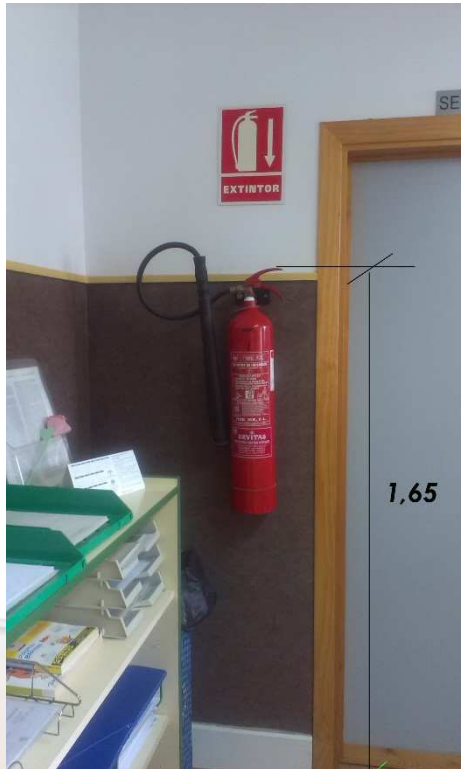
Imagen 43: Altura de colocación extintores Fuente: Fotografía de la autora
