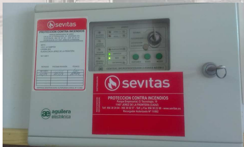
Imagen 53: Panel de centralización de alarmas en Conserjería. Fuente: fotografía de la autora
