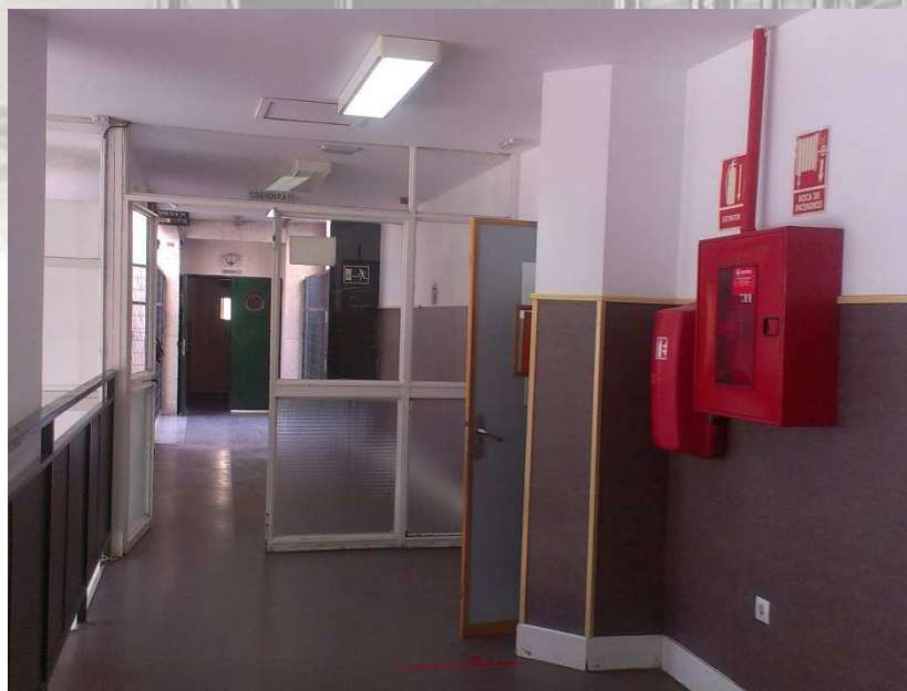
Imagen 51: Extintor correspondiente a la maquinaria del ascensor. Fuente: Fotografía de la autora
