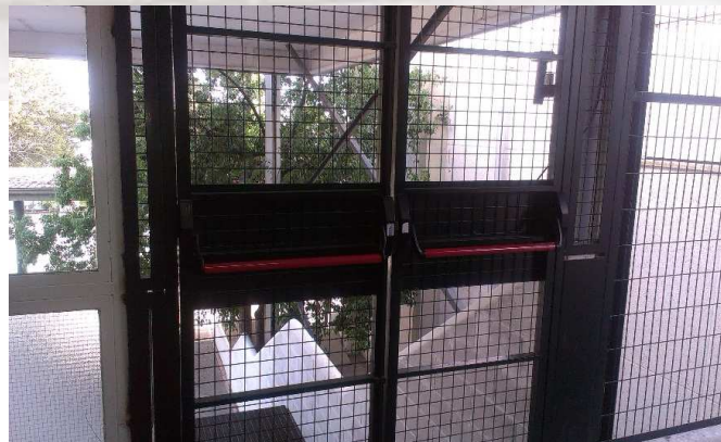
Imagen 37:Puerta con desembarco a escalera Planta Primera.Sistema eléctrico y alarma. Fuente:Fotografía de la autora
