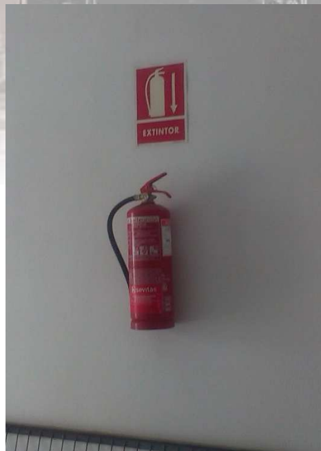
Imagen 49: Extintor en el interior de la sala de calderas Fuente: Fotografía de la autora
