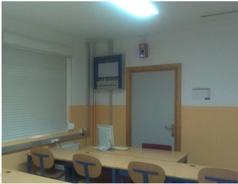
Imagen 16: Cuadros eléctricos en aulas de Planta Primera Fuente: Fotografía de la autora
