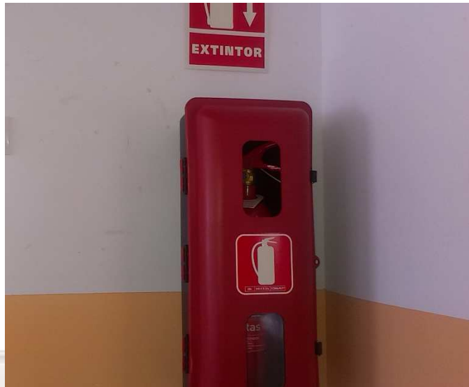
Imagen 50 : Extintor dentro de aula Planta Primera. Fuente:Fotografía de la autora
