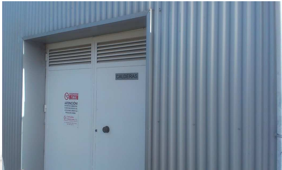
Imagen 48: Entrada a sala de calderas. Fuente: Fotografía de la autora.
