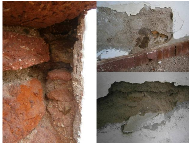
Fig.18. En la imagen de la izquierda encontramos el ladrillo macizo de tono rojizo con mampuestos de piedra interiores; a la derecha se pueden ver las piedras bajo el mortero de cemento. (Elaboración propia).
