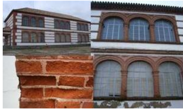
Fig.30. Fachada principal. En la esquina inferior izquierda encontramos el ladrillo rojizo, empleado como elemento decorativo y que aparece erosionado y desgastado por el paso del tiempo. (Elaboración propia).
