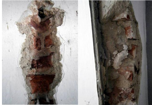
Fig.28. Desprendimiento de material en algunos de los tabiques que nos permiten apreciar su ejecución. (Elaboración propia).
