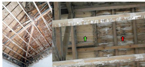
Fig.27. Sustitución de parte del entablonado, la flecha verde indica las tablas sustituidas, la roja las tablas originales las cuales aparecen deterioradas por la humedad. (Elaboración propia).
