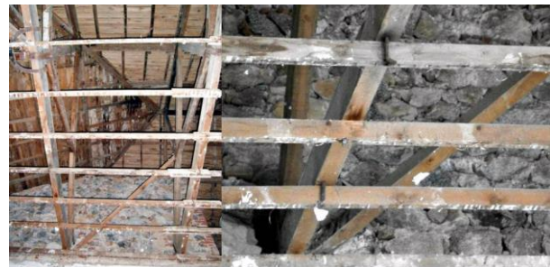
Fig.25. Fotografías de uno de los refuerzos de la estructura. (Elaboración propia).
