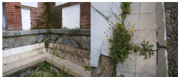
Fig.29. Asientos de la fachada posterior. Una vez más vemos como la vegetación ha proliferado en el muro de piedra, debido a la ausencia de mantenimiento. (Elaboración propia).
