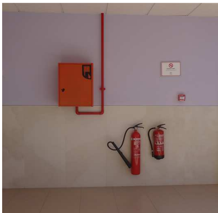
Extintores situados a baja altura y bie. © Anabel Carpio
