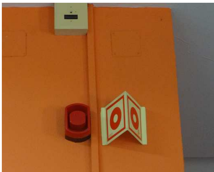
Sistema de megafonía. Correctamente señalado. © Anabel Carpio
