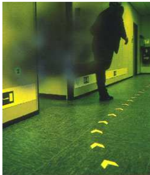
Ejemplo de señales fotoluminiscentes y de balizamientos fotoluminiscentes. Fuente: señales de seguridad SIN.
