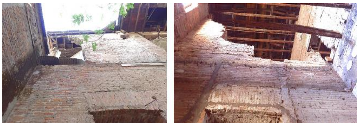
Figura 5: Grietas verticales y colapso del muro. Derecha: colapso de muro de 11.5 m de altura
