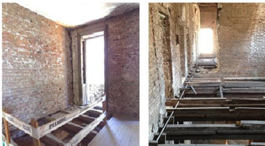
Figura 3: Izquierda: Desacople de muros perpendiculares a fachada Este. Derecha: Rotura de losas en muros perpendiculares a fachada Este.
