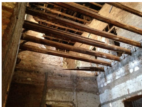
Figura 4: Daño en entablado de madera en losa del segundo piso.
