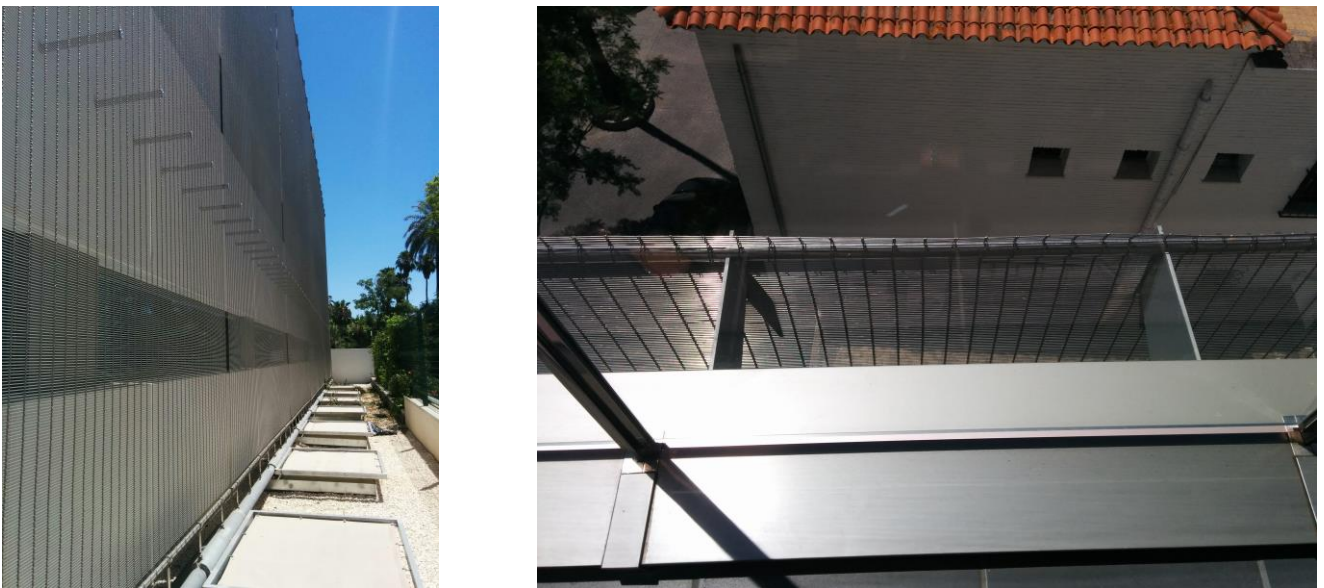
Figura 56: Vista desde el pie de la malla, vista del remate de la malla.
