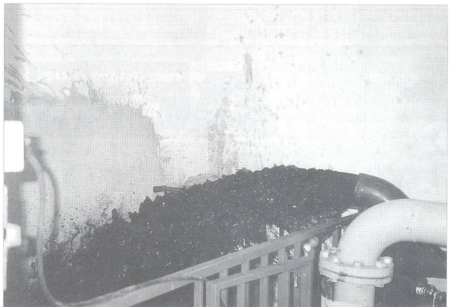
Foto 1. Agua de salida durante la limpieza de la tubería c/ Picasso.
