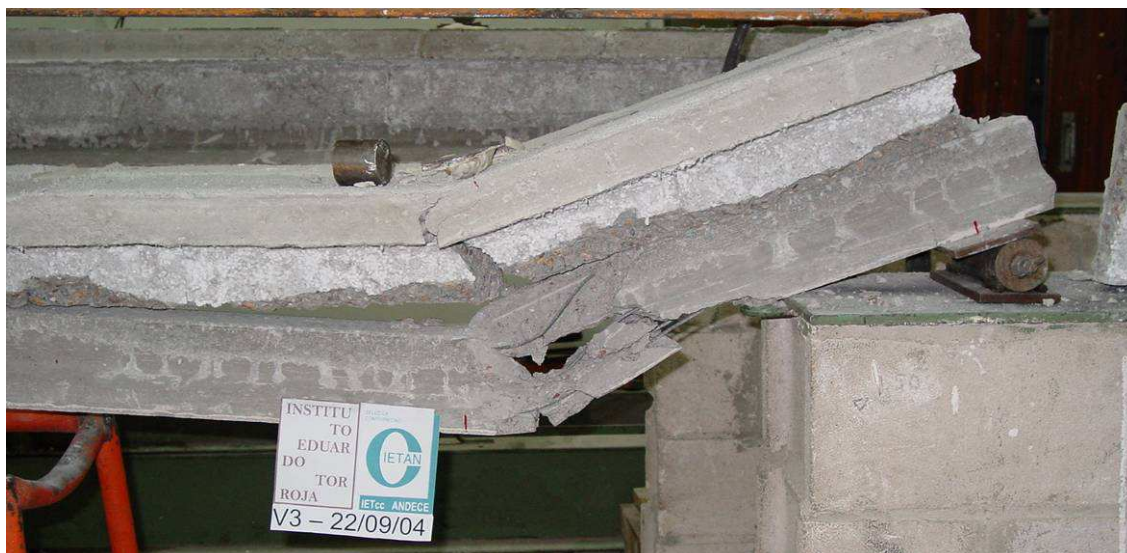
Imagen IV.3.4.-b Rotura por rasante / cortante en forjado P03c (T-11-3). All-pg.646
