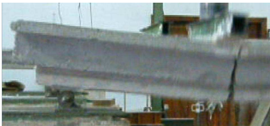
Imagen IV.3.3.2.1.-a. Rotura en forjado A01bis (T-11-2) por flexión. All-pg.601
