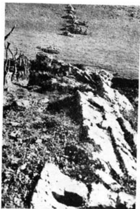
Fig. 10.—Estado actual del acueducto sobre el Alpariate.
