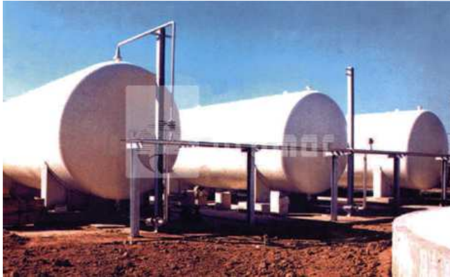
Ilustración 27 Ejemplos de gasómetros de media y alta presión.
