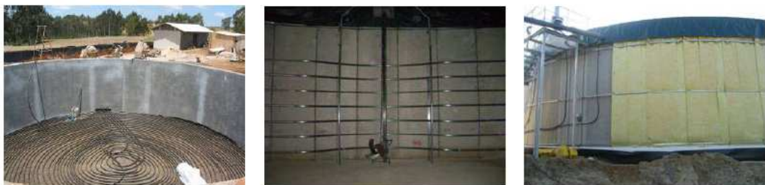
Ilustración 41 Diferentes partes de un sistema de calefacción de un digestor anaerobio.
