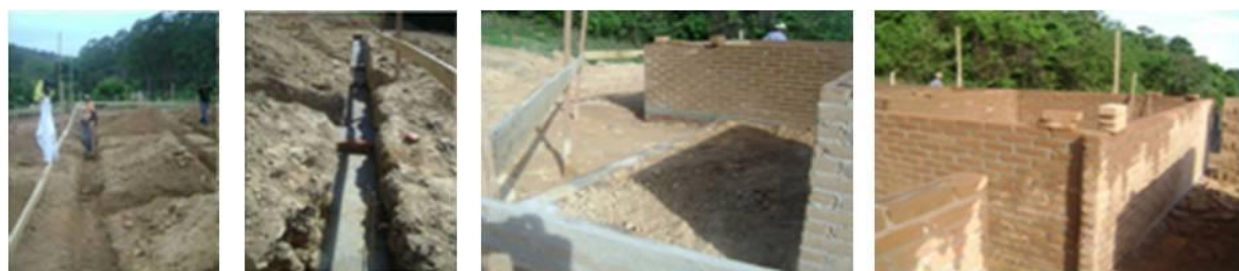
Figura 5: O gabarito, a concretagem da sapata corrida e o assentamento da alvenaria armada empregando os BTC's. Fonte: Parisi, 2008.
