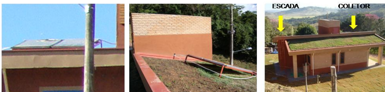
Figura 13: As placas solares foram fixadas sobre um suporte metálico no teto verde e a escada metálica, para a acessibilidade à manutenção, foi colocada na face esquerda do prédio. Fotos: GEAHs, 2010.
