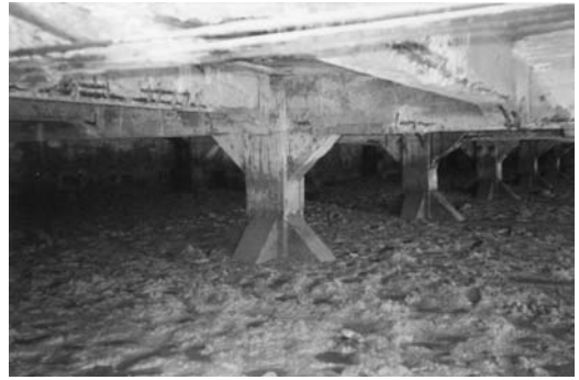
Figura 6 Estado del muelle bajo la Lonja hacia 1999. Fuente: Programa de Intervención en el Patrimonio Público de Interés Arquitectónico. Junta de Andalucía
