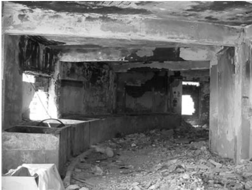
Figura 12 Estado interior de la lonja. Julio de 2004. Fuente: Elaboración propia
