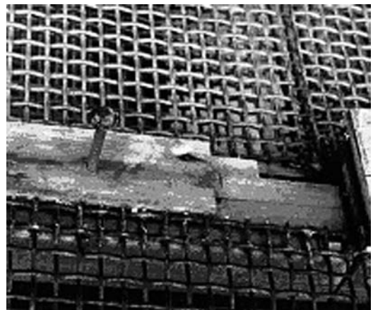
Figura 14 Pabellón de Checoslovaquia Expo'92. Estado de las fijaciones de acero galvanizado. Fuente: E. Morales. AITIM 220
