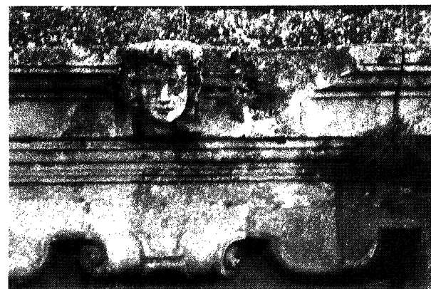
f) Fracturaciones y fragmentaciones en cornisas.
