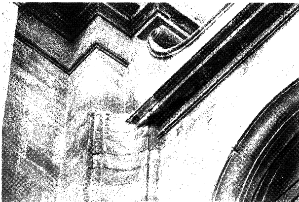
e) Arenizaciones junto a cornisas.
