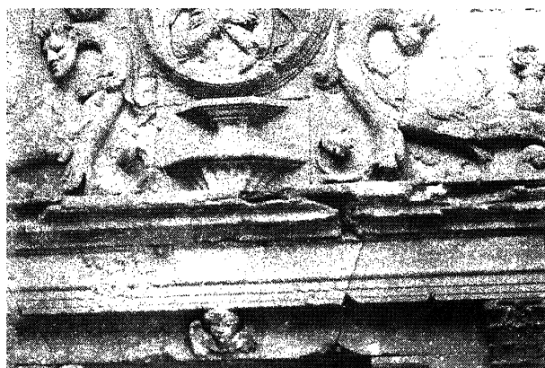
e) Degradaciones diversas en la portada.
