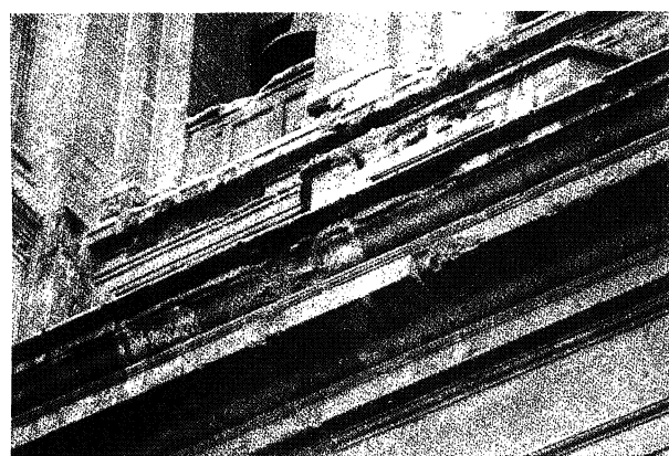
d) Diversas pérdidas de material en cornisas.
