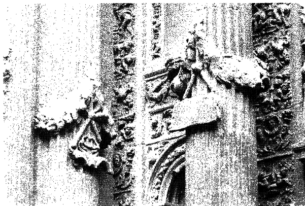
e) Arenizaciones en zonas lavadas. e) Grain disgregations on washed areas.
