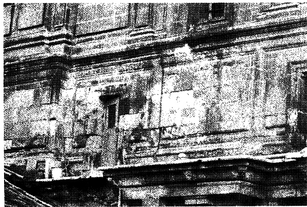
b) Picados y arenizaciones en la torre.
