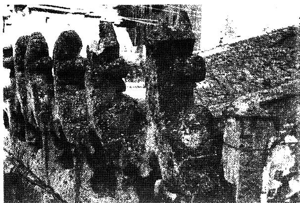
a) Fisuraciones por congelación.
