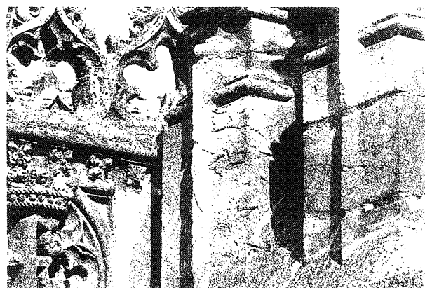
c) Fisuraciones en bases de pináculos.
