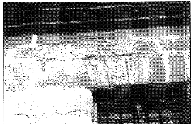
d) Exfoliaciones. d) Peeling.
