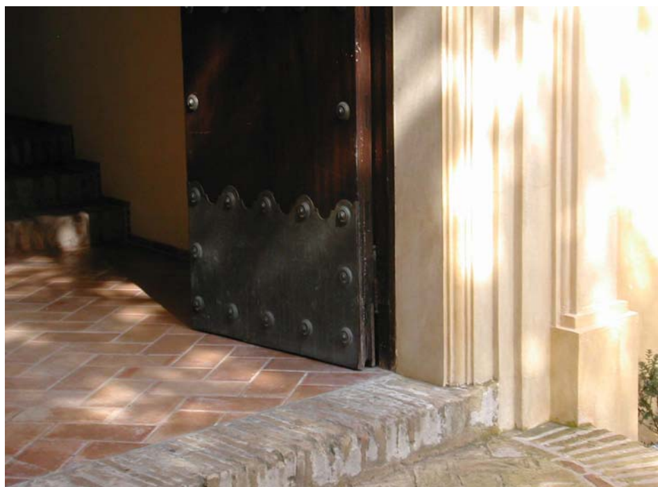
Figura 28. Detalle de la parte inferior del marco de la portada terrajada y estucada de la fachada norte.
