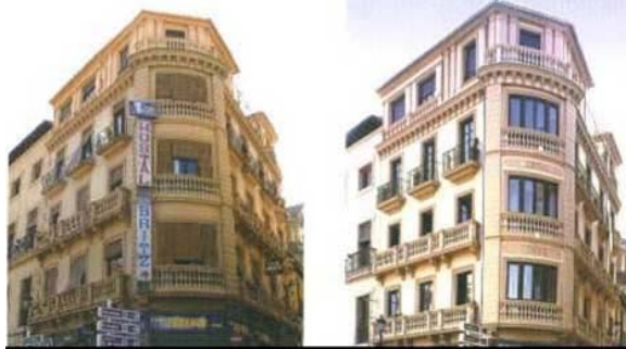
Viviendas antes y después de la intervención Fotos del INSTITUTO Municipal de Rehabilitación, Ayuntamiento de Granada, Vivir en la ciudad histórica . Granada, Encuadernaciones Olmedo, 2003.
