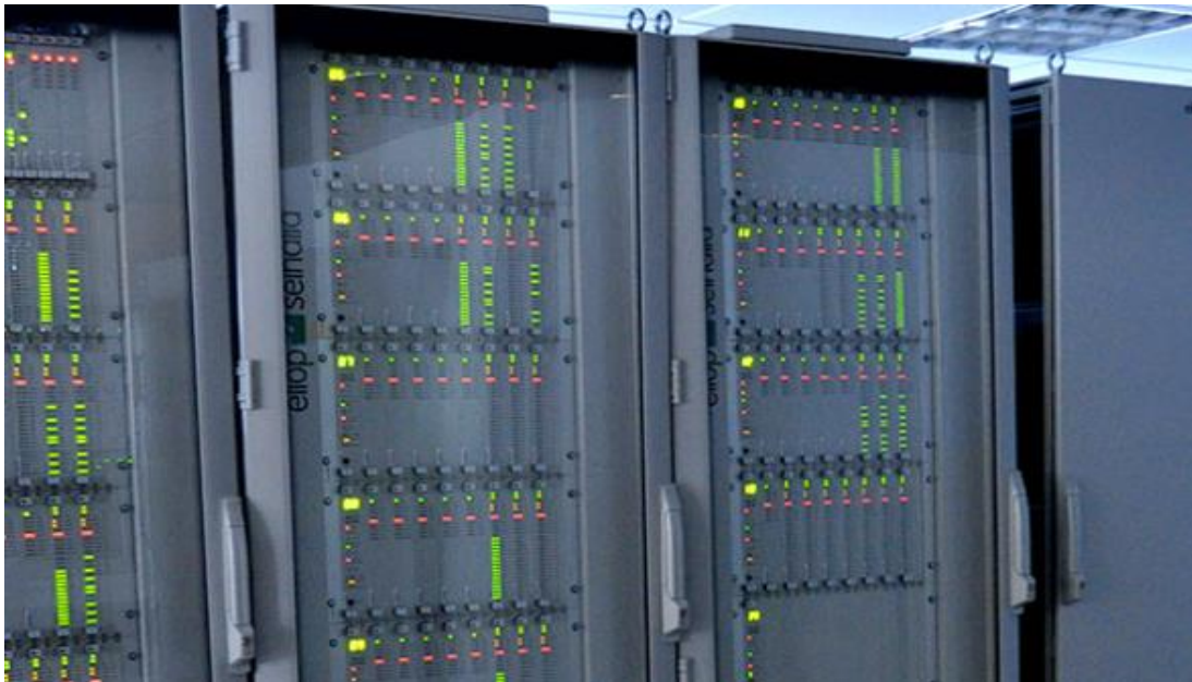
Figura 8. Armario de un enclavamiento electrónico, que alberga todas las variables electrónicas responsables de controlar los diversos elementos de la vía en una estación.
