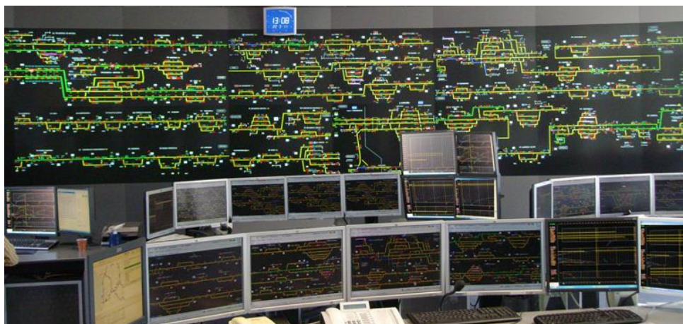
Figura 3. Ejemplo de un puesto de mando central donde se controla todo el flujo de trenes de varias estaciones.
