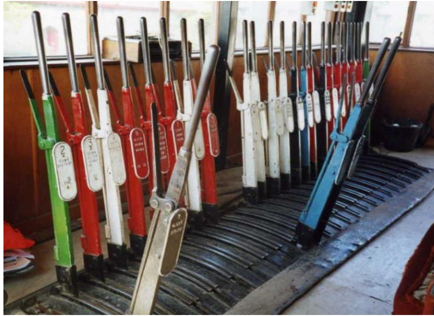
Figura 7. Enclavamiento mecánico, capaz de manejar señales, desvíos, pasos a niveles...
