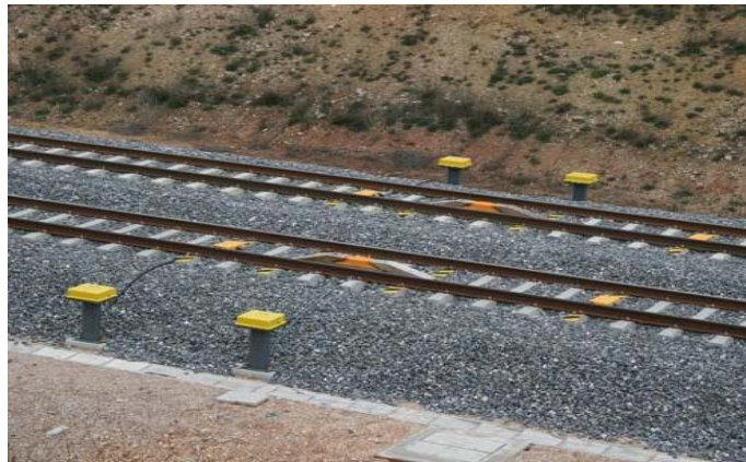
Figura 10. Balizas (Transmiten al tren el estado de las señales).
