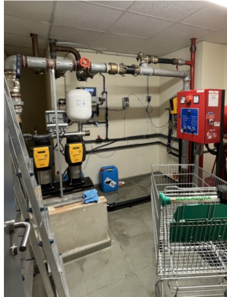
Figura 15. Sala de máquinas del edificio
