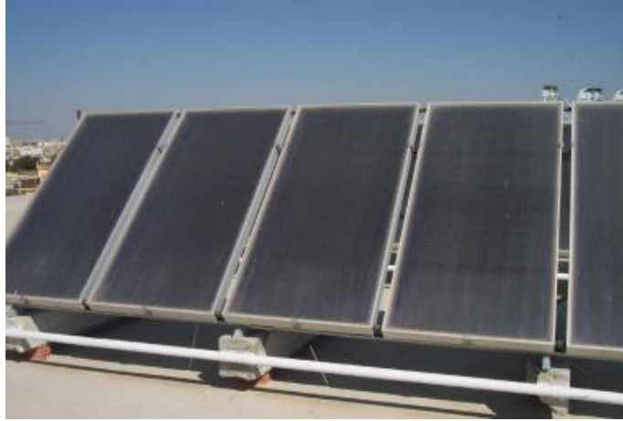
Figura 6. Captadores solares térmicos (1).
