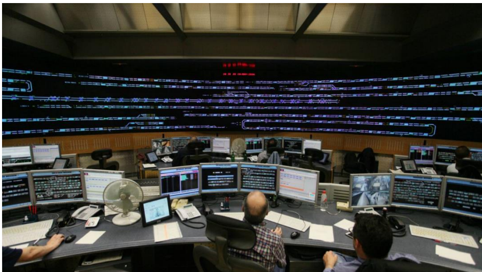
Figura 17. Centro de control del metro de Madrid.
