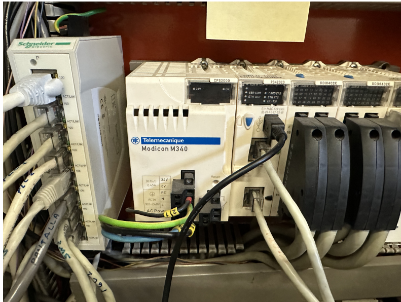
Figura 3.2 PLC Modicon M340 usado en el proyecto.
