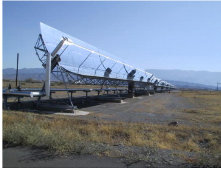
Figura 1.2 Campo de cilindros parabólicos en una central termosolar [5].
