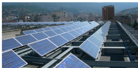
Figura 1.1 Placas solares sobre el tejado de un edificio [24].
