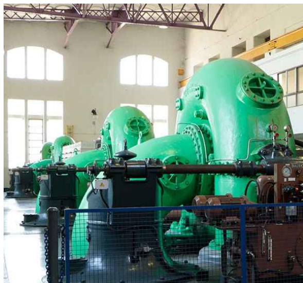
Ilustración 19. Interior planta de máquinas. Fuente: (Endesa, 2024)
