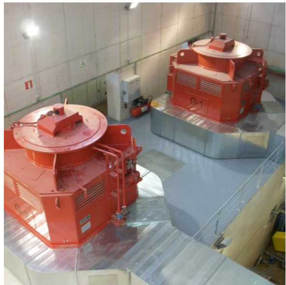
Ilustración 23. Alternadores de la CH Toma del Canal. Fuente: (CANASA, 2024)
