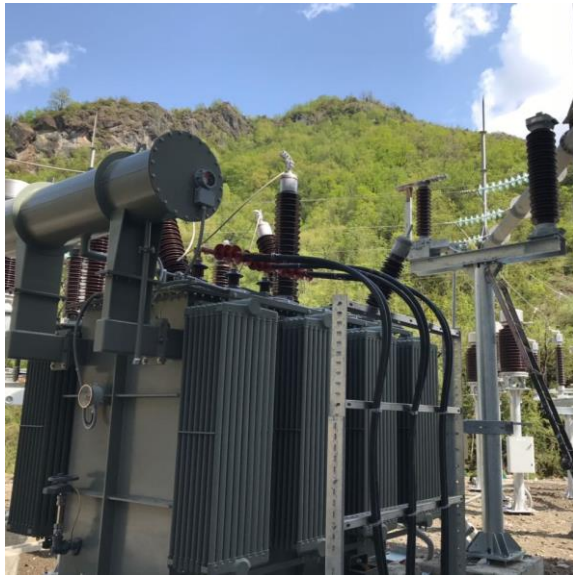
Ilustración 26. Transformador para central hidroeléctrica en Albania. Fuente: (C.R. TECHNOLOGY SYSTEMS, 2024)
