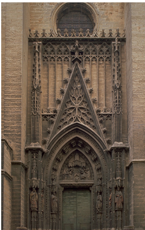
Fig. 1 Portada del Nacimiento antes de iniciar la intervención
