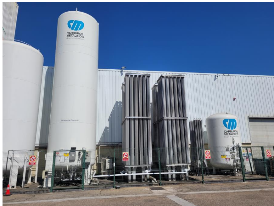
Figura 32. Depósito de CO 2 junto con intercambiadores
