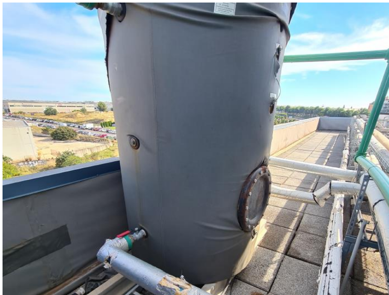
Ilustración 27. Acumulador ACS operativo de la instalación en Paterna (Valencia). Fuente: Propia
