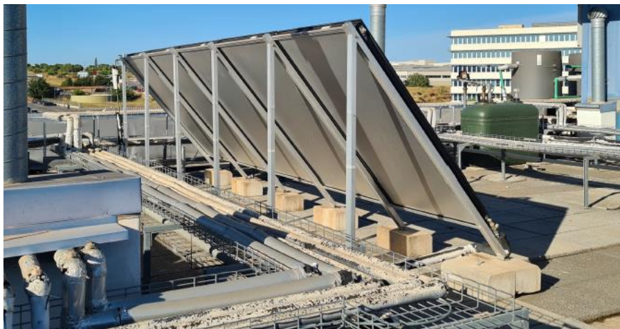
Ilustración 26. Batería desde atrás junto a bandeja con tuberías del circuito primario (auditoría). Fuente: Propia
