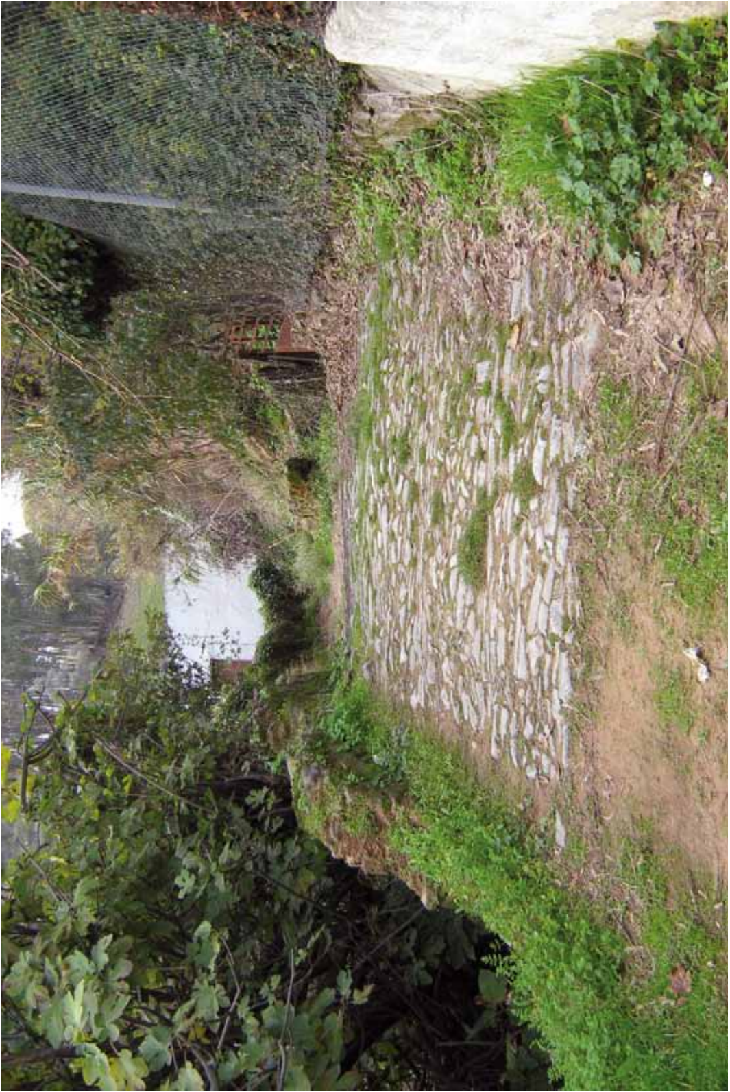
23.- Puente. Conserva el empedrado de cantos de caliza, de tamaño pequeño y mediano; y buena parte de los pretilos de mampostería. M.T. Henares. 2009.
