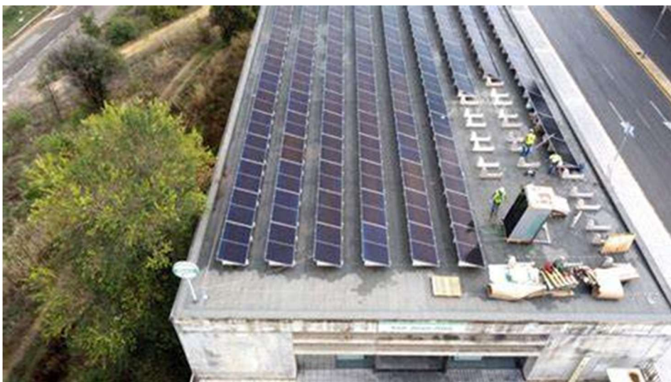
Figura 42-6.6 Instalación fotovoltaica para autoconsumo en la cubierta del metro de Sevilla. Fuente: centrohistorico.info
