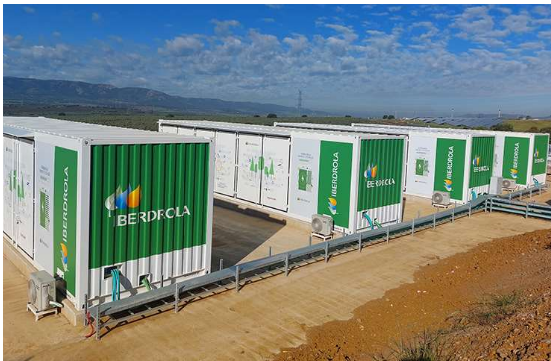
Figura 35-6.2.1 Baterías Iberdrola. Fuente: Iberdrola.com
