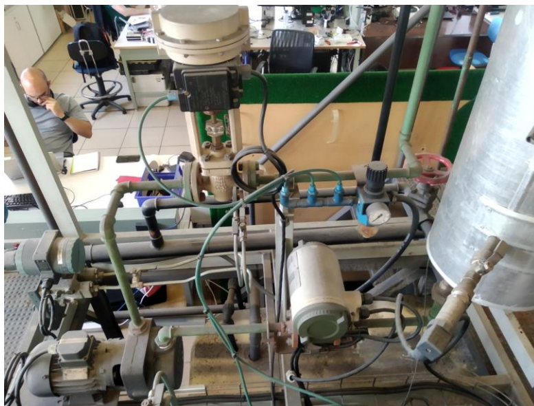
Figura 2- 6: Detalle de la tubería de realimentación
