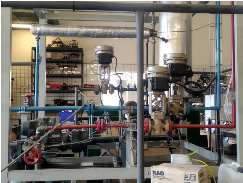
Figura 2- 5: Detalle del intercambiador y de las tuberías de agua fría y caliente
