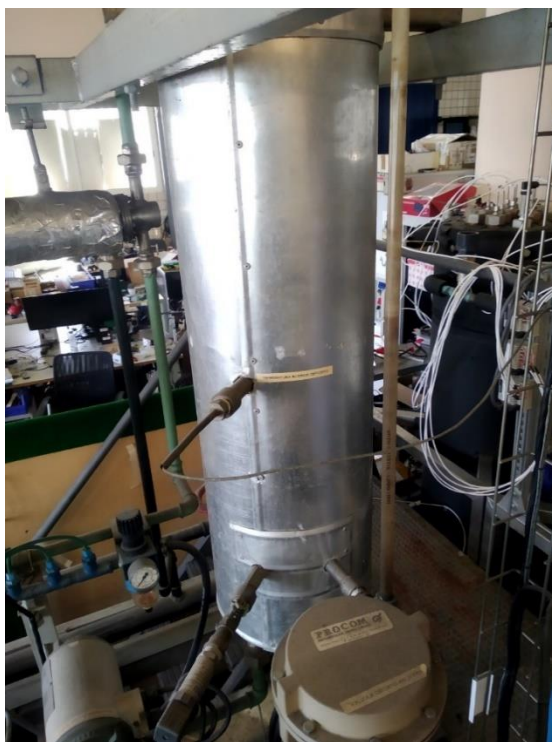
Figura 2- 4: Depósito de la instalación
