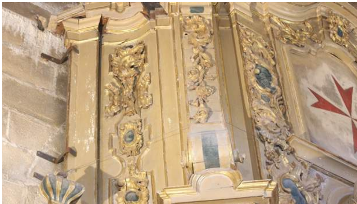
Ilustración 26: En esta imagen se pueden apreciar gran variedad de alteraciones como separaciones de piezas, pérdidas de piezas, suciedad, etc. Pero sin duda lo que más nos llama la atención es la sujeción al paramento, para reforzarla se han añadido unas grapas metálicas e incluso se encuentra “abrazado” por un cable metálico al muro, aspecto preocupante que revela la falta de estabilidad que poseen algunos retablos de la colección. [Imágenes tomadas por José Antonio Romero, 2023]
