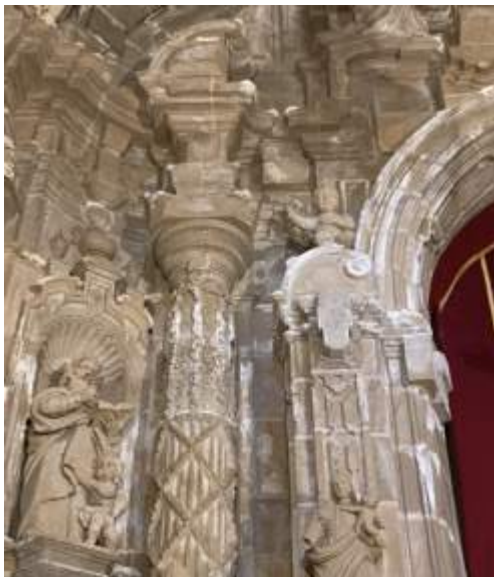
Ilustración 22: Eflorescencias salinas y pulverulencia de la superficie rocosa en el retablo de Ánimas (NEV2_1_1). [Imagen tomada por Pablo Tejero Cárdenas, 2023]
