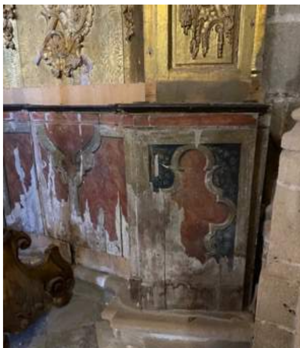
Ilustración 28: Visión del sotobanco del Retablo de San Pedro. En él vemos como la humedad de infiltración proveniente del subsuelo ha afectado gravemente provocando graves pérdidas en la capa de revestimiento o policroma. Además, ha afectado al soporte provocando pudrición de la madera que ha intentado enmascararse con unos añadidos de panel contrachapado. Sin duda un grave problema, que como ya ocurre en otros retablos de la colección, acabará afectando a la estabilidad estructural del retablo. [Imagen tomada por Pablo Tejero Cárdenas, 2023]
