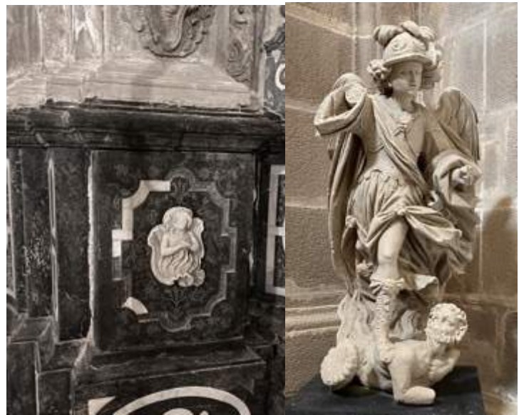
Ilustración 23: Faltas volumétricas en el zócalo de la capilla de Ánimas (izq). Rotura de la piedra y pérdidas volumétricas (dcha). [Imágenes tomadas por Pablo Tejero Cárdenas, 2023]
