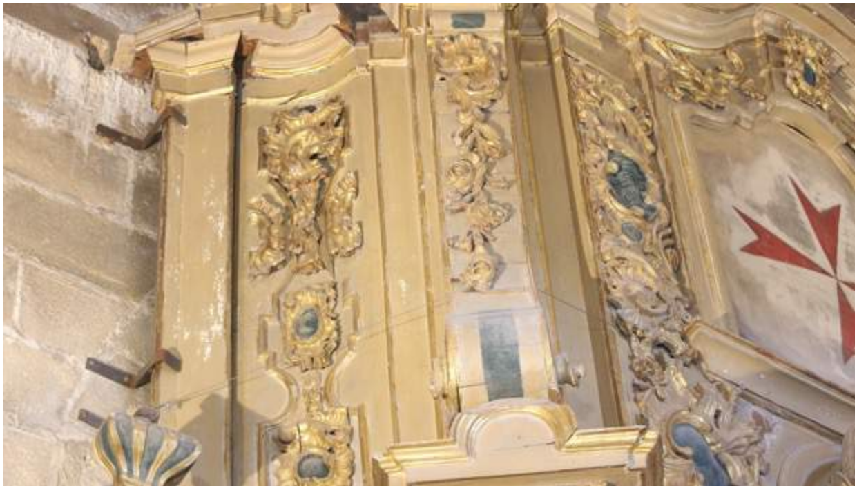
Ilustración 26: En esta imagen se pueden apreciar gran variedad de alteraciones como separaciones de piezas, pérdidas de piezas, suciedad, etc. Pero sin duda lo que más nos llama la atención es la sujeción al paramento, para reforzarla se han añadido unas grapas metálicas e incluso se encuentra “abrazado” por un cable metálico al muro, aspecto preocupante que revela la falta de estabilidad que poseen algunos retablos de la colección. [Imágenes tomadas por José Antonio Romero, 2023]
