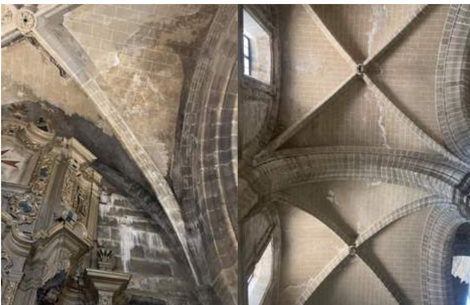
Ilustración 15: Manchas de humedad y eflorescencias salinas en las cubiertas. Problema generalizado en las techumbres del templo. [Imágenes tomadas por Pablo Tejero Cárdenas, 2023]
