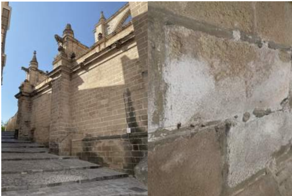
Ilustración 16 Vista del muro exterior desde la calle Aire donde se evidencia el desnivel que salva el inmueble. Ataques microbiológicos resultado de la mala canalización de aguas pluviales (izq). Eflorescencias salinas producto de la humedad de infiltración en la cara interior de los paramentos (dcha). [Imágenes tomadas por Pablo Tejero Cárdenas, 2023]
