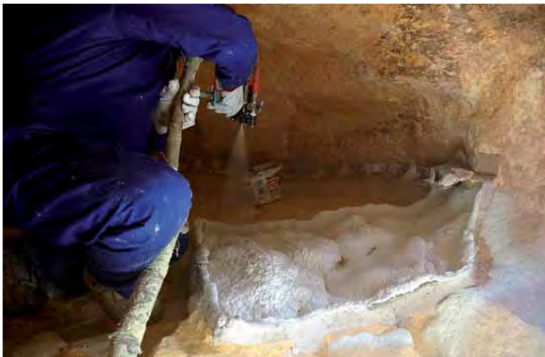
Lámina 10.13. Véanse en esta imagen y en la siguiente los cambios en la posición de la pistola para alcanzar toda la superficie.
