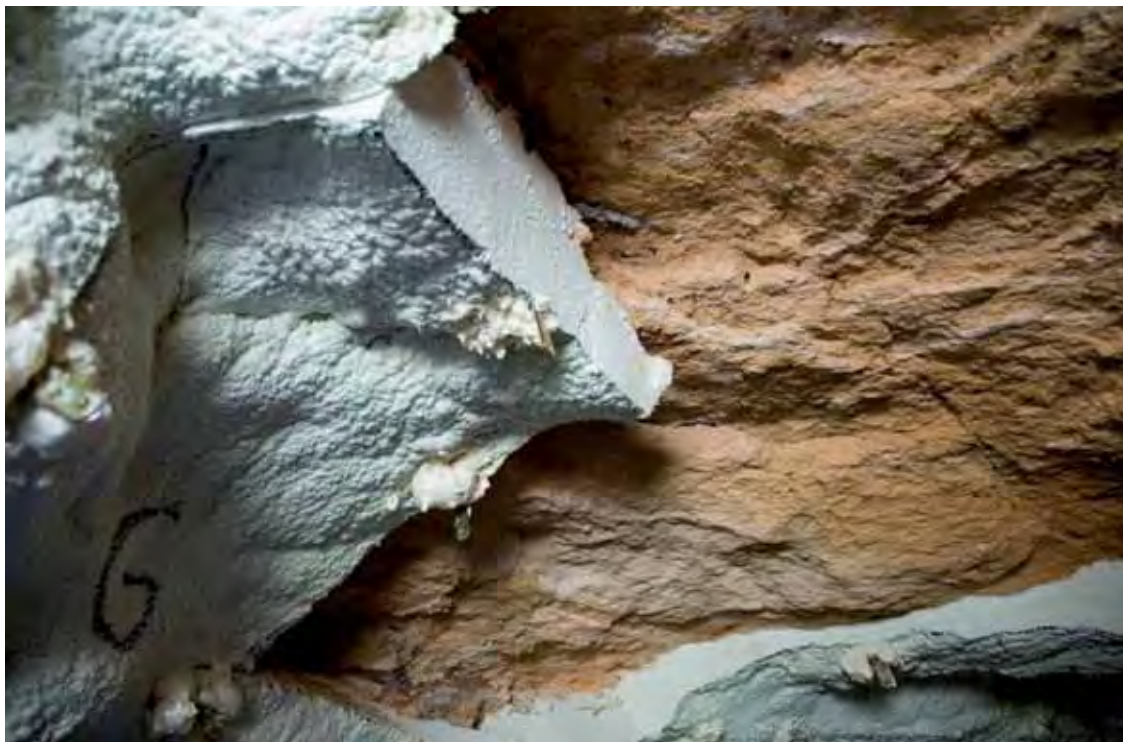
Lámina 10.32. Separación de piezas en la parte del techo de la bóveda.
