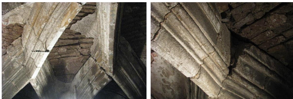
Figura 5. Grietas y desplazamientos en los nervios.
