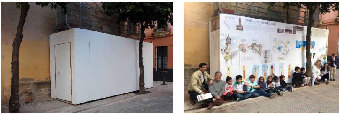
Figura 3: Cerramiento de obra de restauración de la torre: lienzo blanco decorado mediante instalación de urban sketchers y niños.
