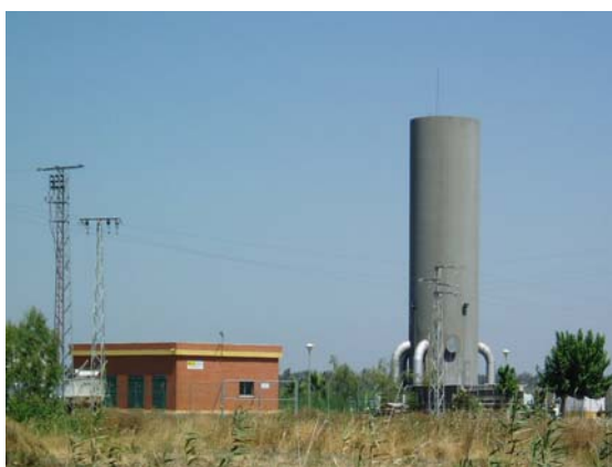
Figura II.15. Estación de Bombeo Sector BXII.
