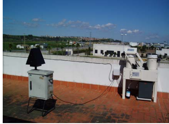
Figura II.12. Azotea EDAR Aljarafesa.
