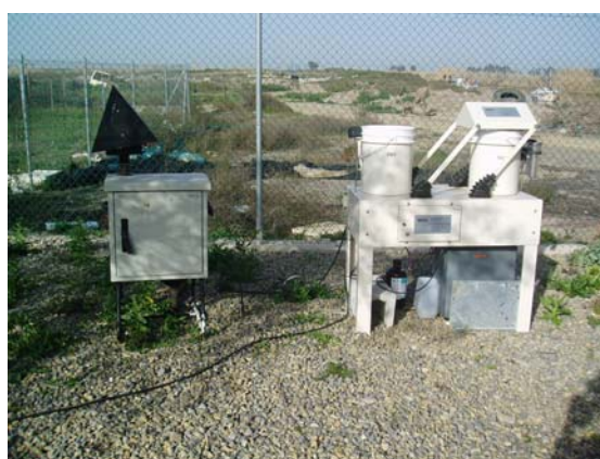
Figura II.16. Muestreadores en la Estación de Bombeo.
