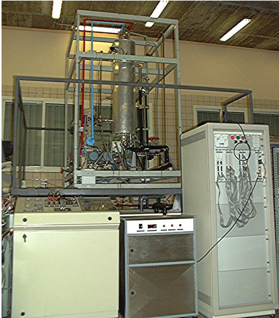
Figura B.4: Paneles de los controladores y controlador lógico programable
