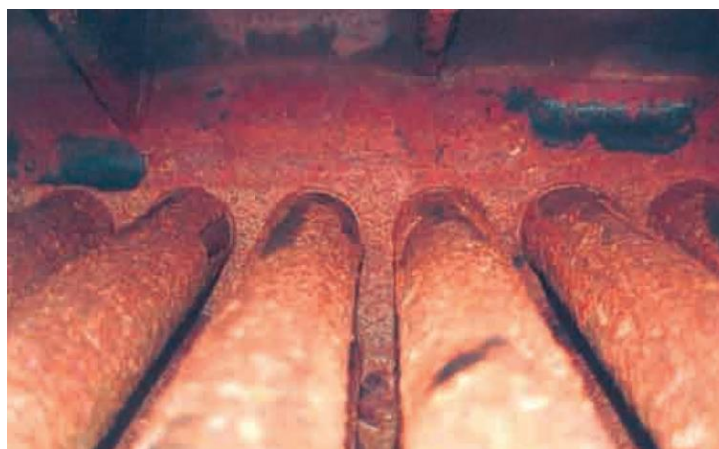
Figura 21. Incrustaciones en una caldera de vapor [2]
