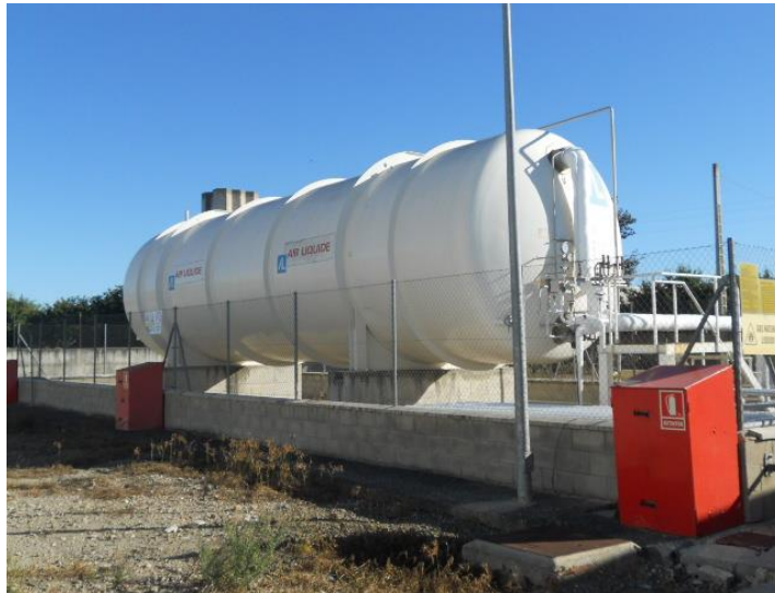
Figura 1-5. Tanque de GNL.
