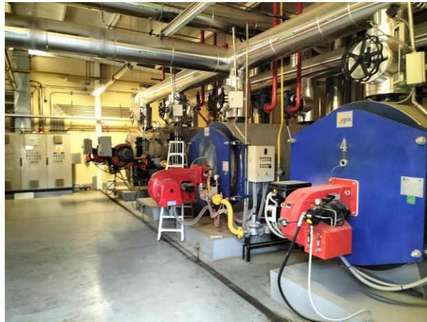
Figura 1-2. Sala de calderas actual.
