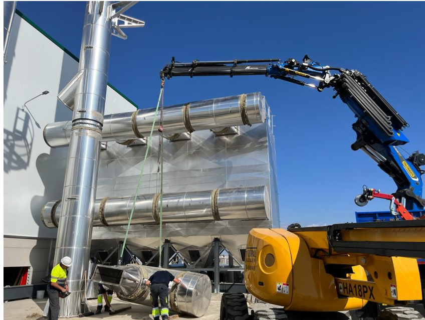
Figura 2-20. Filtros de mangas. (Cortesía de Veolia)
