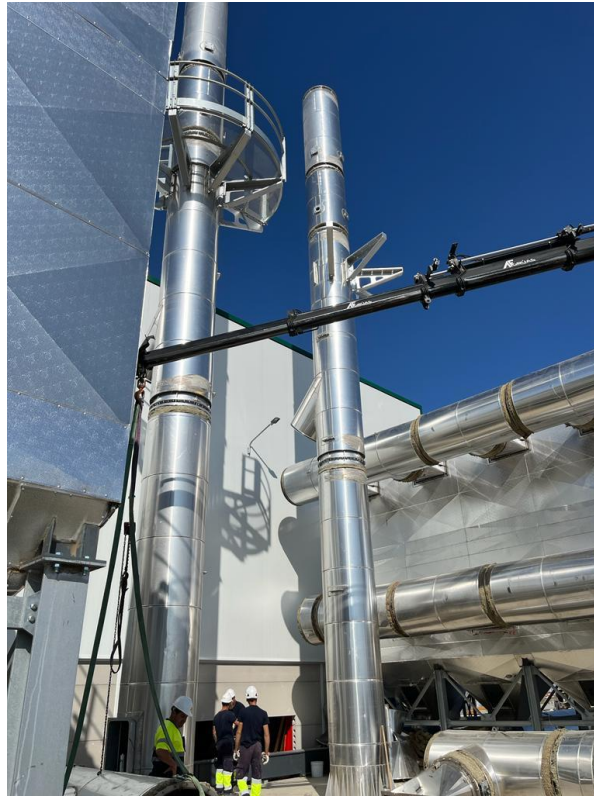
Figura 2-22. Chimenea. (Cortesía de Veolia)
