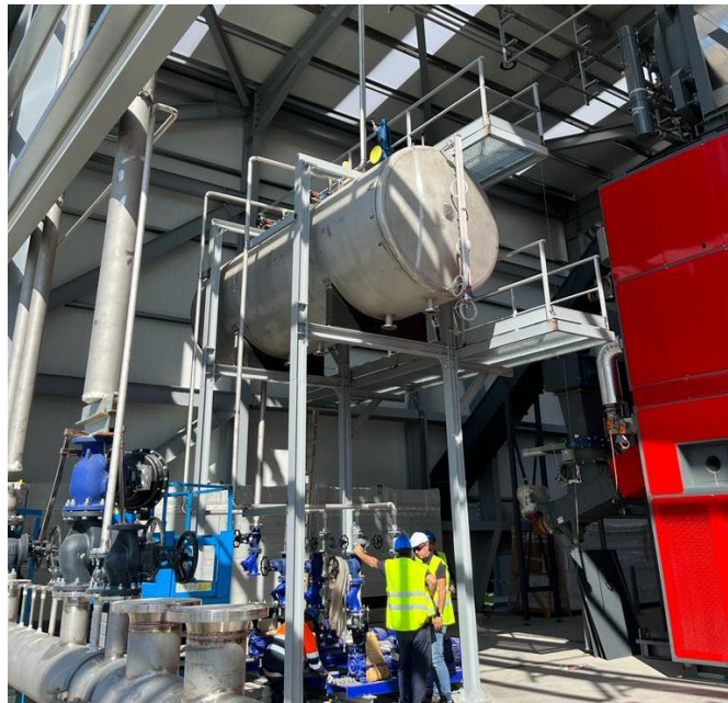
Figura 2-18. Acumulador de agua condensada. (Cortesía de Veolia)
