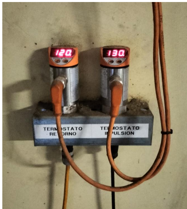
Figura 2-5. Salto térmico circuito ASC.
