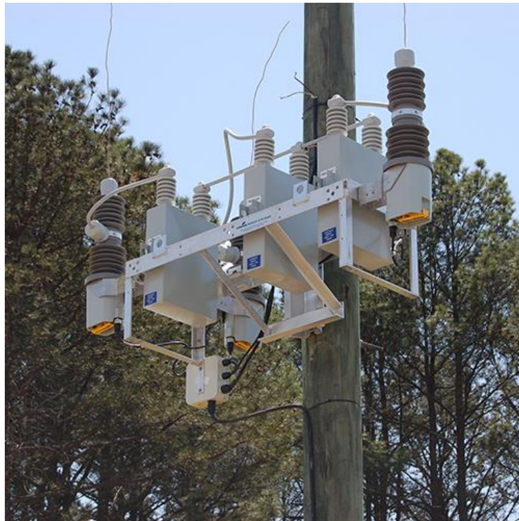
Figura 2-26. Banco de Capacitores en una red de distribución [25].
