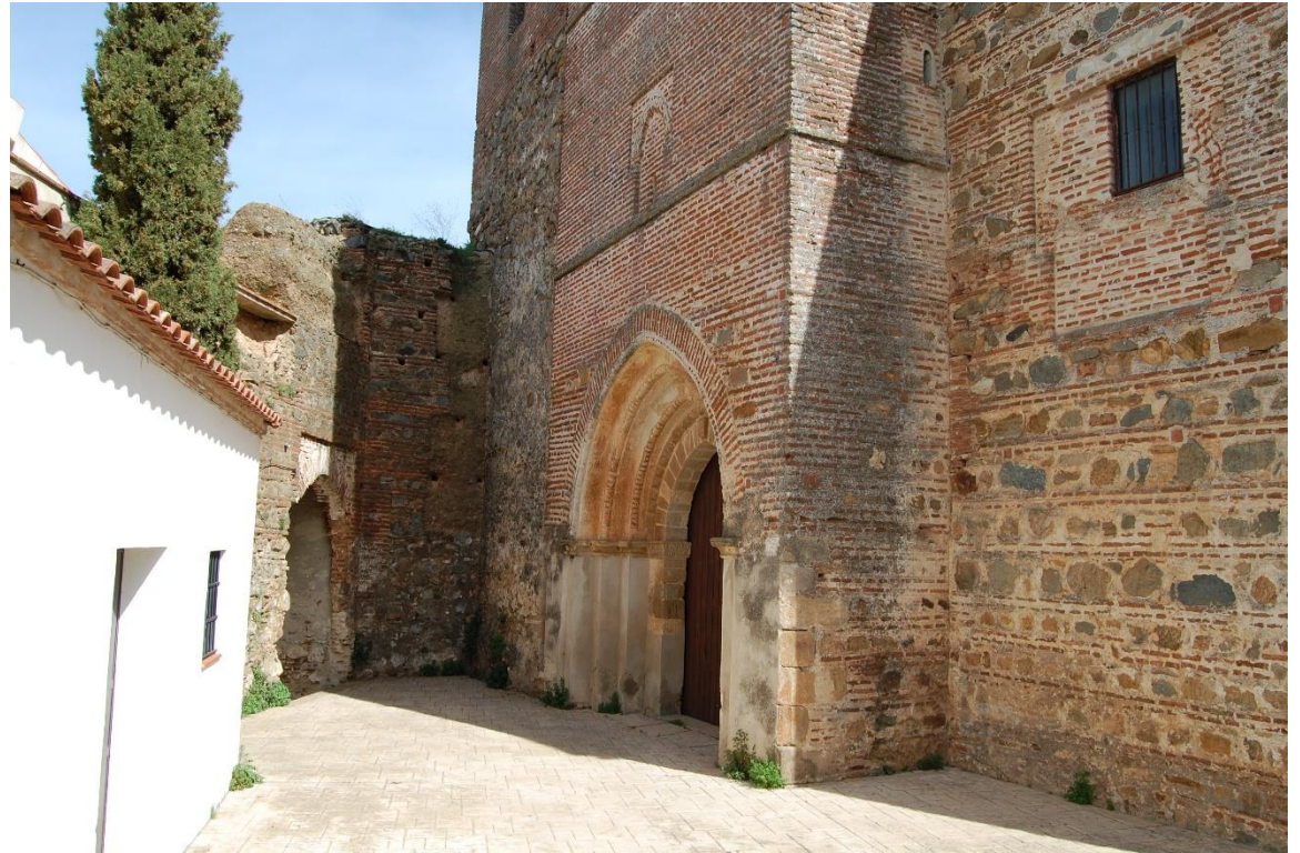
Fig. 2.12. Fotografía de la unión del cerramiento exterior con la nave lateral de la iglesia (Autor)
