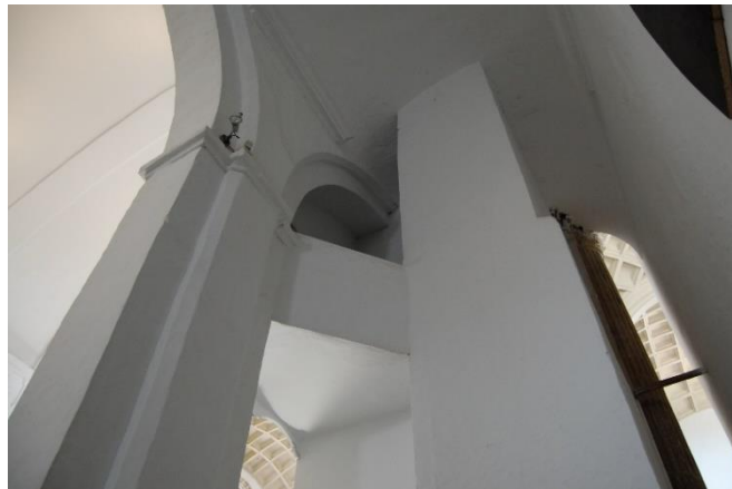
Fig. 4.17. Arco de época mudéjar cegado para soportar mejor los esfuerzos estructurales (Autor)
