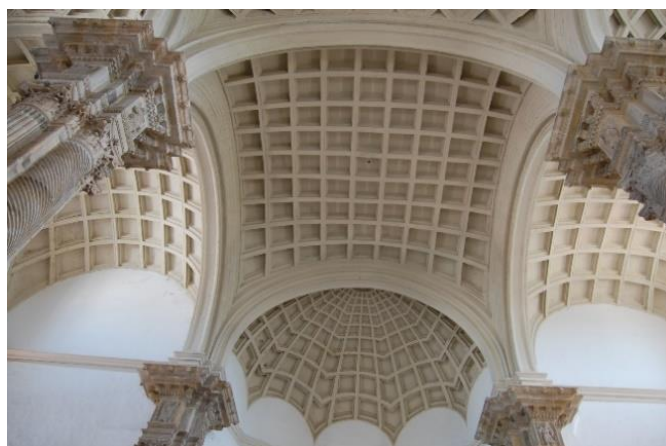
Fig. 3.4. Vista inferior de la bóveda junto al presbiterio, que evidencia una geometría muy diferente a la de las laterales. (Autor)
