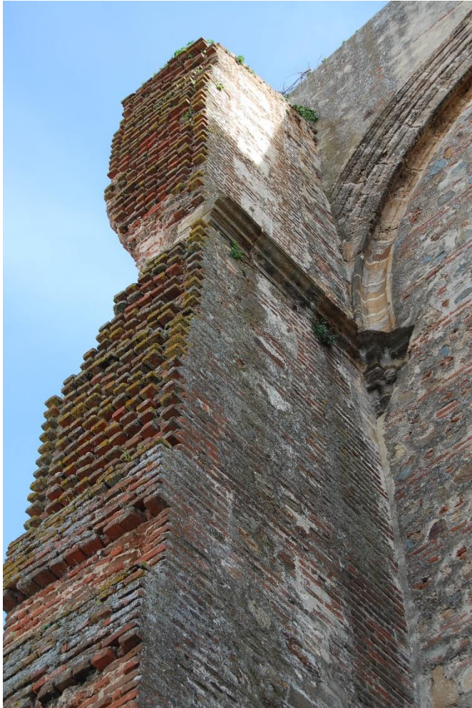
Fig. 4.22. Pilastra exterior que presenta adarajas (Autor).
