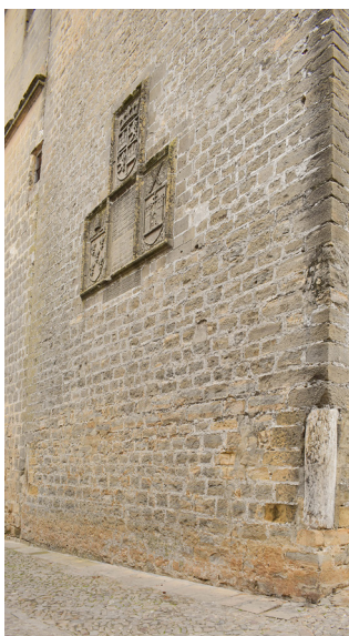
Figura 5. Torre de la Catedral de Baeza. Fuste de columna encastrado.
