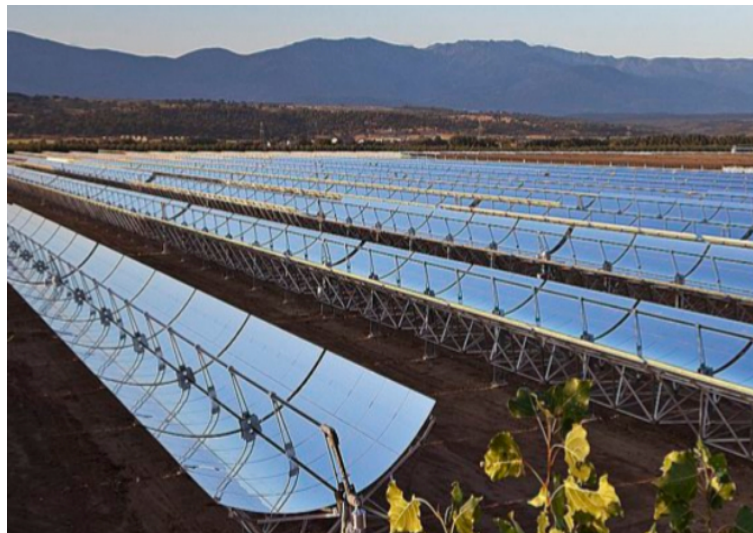
Figura 2.4 Placas de tecnología cilindro-parabólica. En la imagen se aprecian las placas dispuestas en orden y los tubos receptores en su centro.
