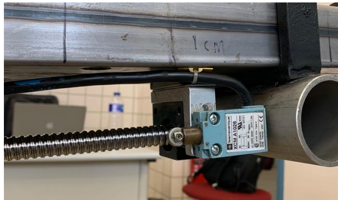
Figura 3.17. Detalle del final de carrera instalado en el extremo del husillo más lejano a la articulación de la viga.
