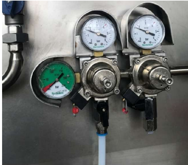
Imagen 23. Controlador manométrico del anillo de CO 2 de Factoría Cruzcampo.
