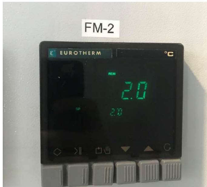
Imagen 24. Display del controlador PID de temperatura del anillo refrigerante de Factoría Cruzcampo.
