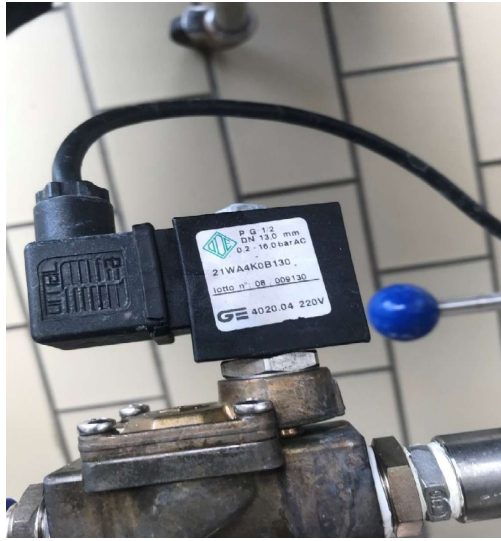
Imagen 26. Detalle de la electroválvula
