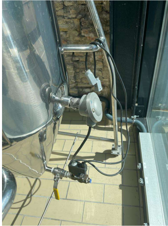
Imagen 28. Entrada de etilenglicol al fermentador controlado por la electroválvula.
