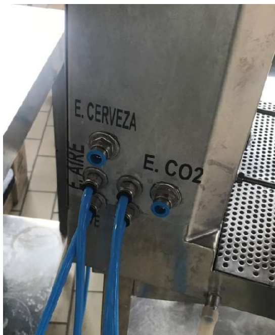
Imagen 31. Detalle perfil de la embotelladora para entradas y salidas de CO2, aire y cerveza o productos de limpieza o de desinfección.
