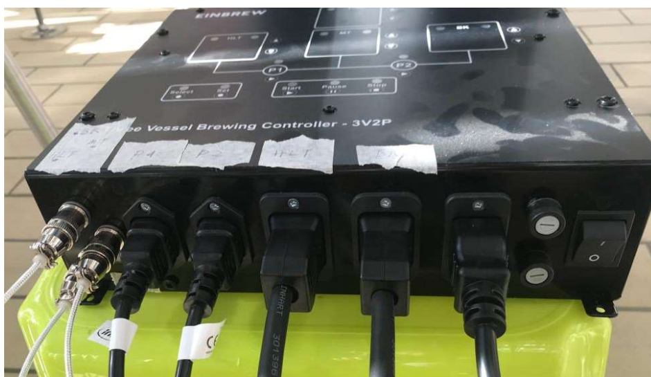
Imagen 33. Conexiones del controlador previamente a su energización.
