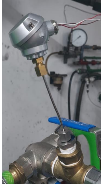
Figura 21. Analizador de conductividad (PT100)
