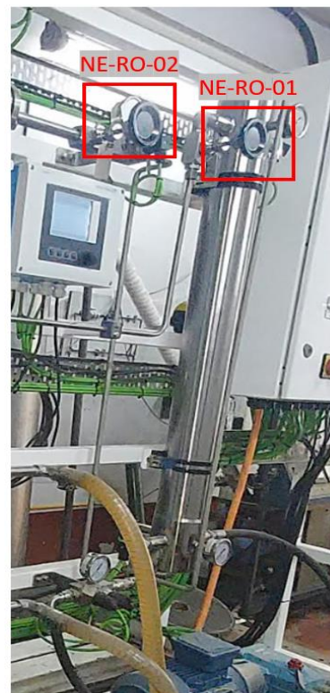
Figura 11. Válvulas de regulación de presión
