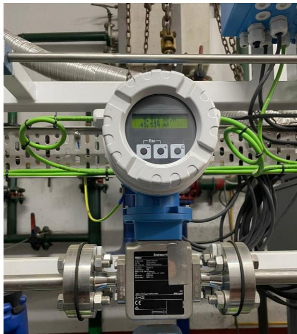
Figura 20. Transmisor de caudal
